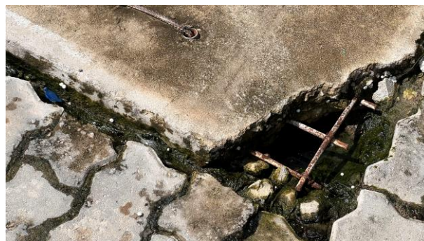
FOTO 04: Caixa de esgoto saturada
