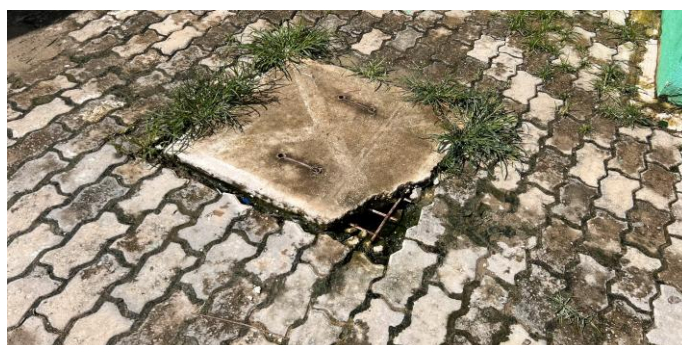
FOTO 05: Caixa de esgoto saturada
