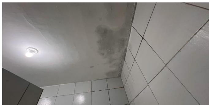
FOTO 07: Manchas de umidade
