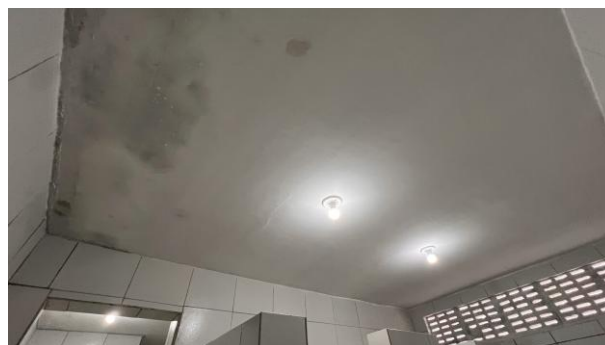
FOTO 08: Manchas de umidade
