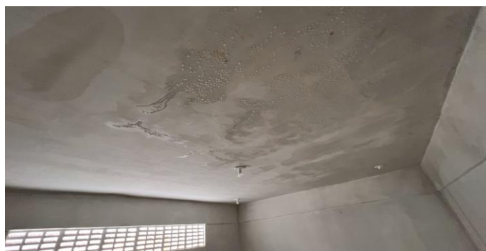
Foto 13: Manchas de umidade
