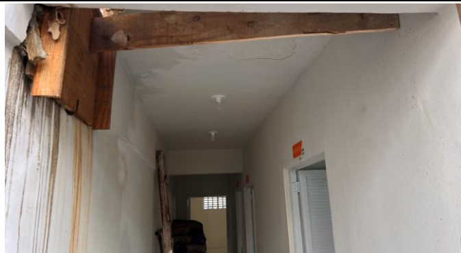
Foto 15: Manchas de umidade
